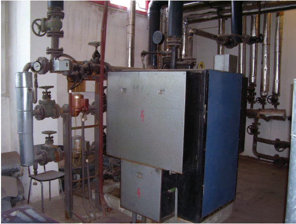
dva elektrokotle o celkovém tepelném výkonu 476 kW
