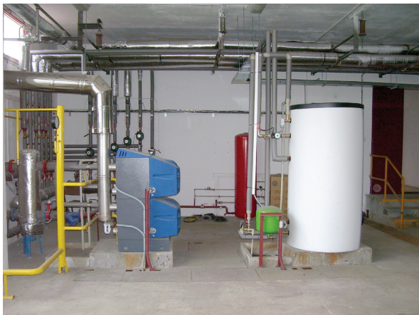
nová kotelna po rekonstrukci – celkový pohled
