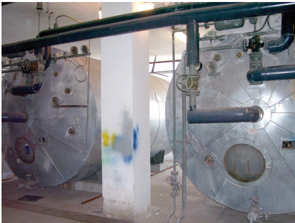
dvě akumulční nádrže pro systém ústředního vytápění o objemu 2 x 25 m 3
