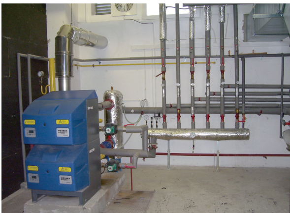
kotelna po rekonstrukci - kotel a sběrač ÚT
